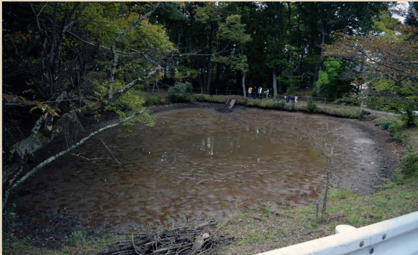
【魚捕り終了後の水抜き状況】 上から3番目の樋を開放したら、通常水位時と比べて9割以上の池水がなくなった。
